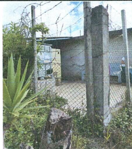
Foto 2: Reparación del muro perimetral, actualmente se encuentra dañado, lo que permite el ingreso de personas ajenas al establecimiento y de animales.
